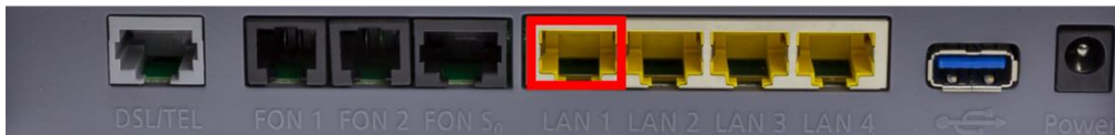
Hier wird das ankommende Kupfer-Netzwerkkabel das von dem Genesis FiberTwist kommt eingesteckt
